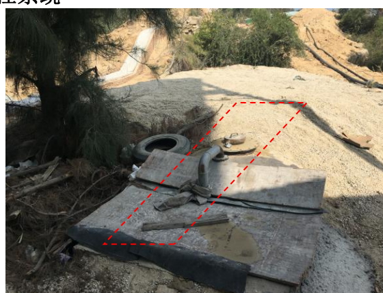
柴油储罐(埋地)
