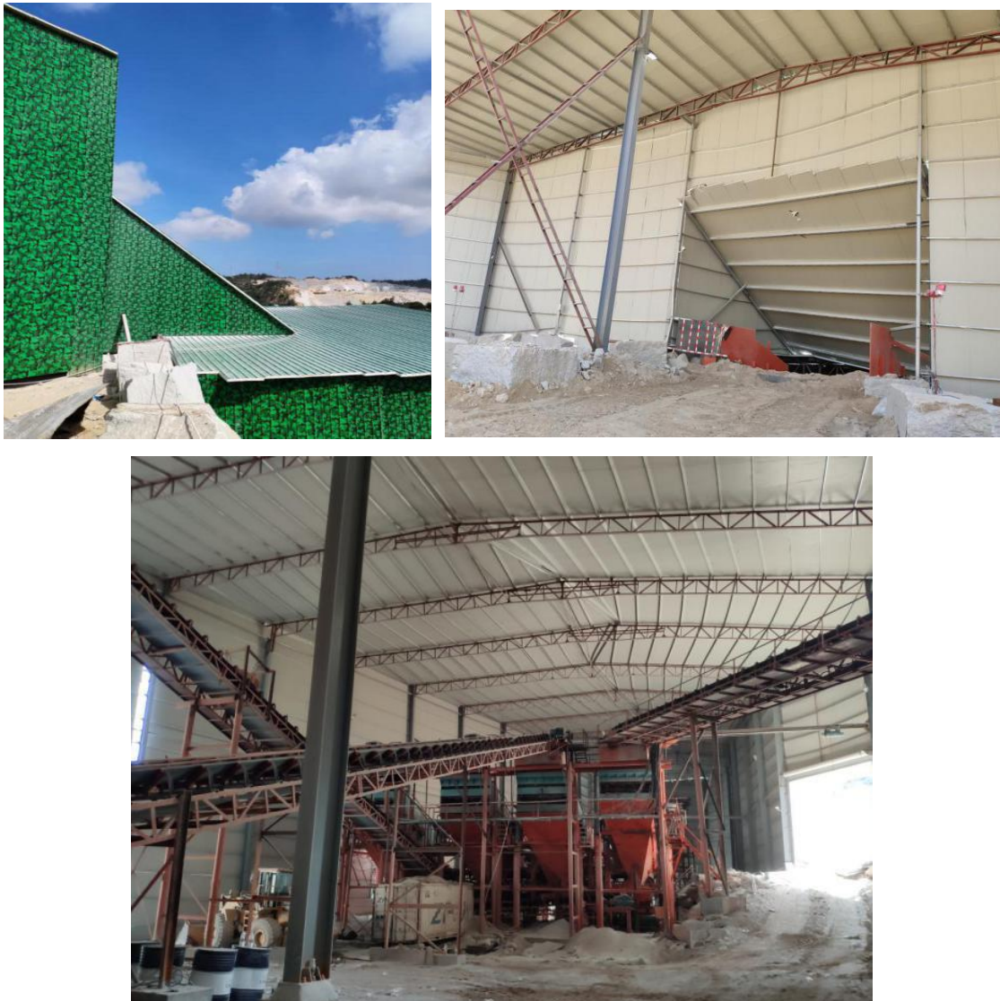
破碎、筛分车间封闭
